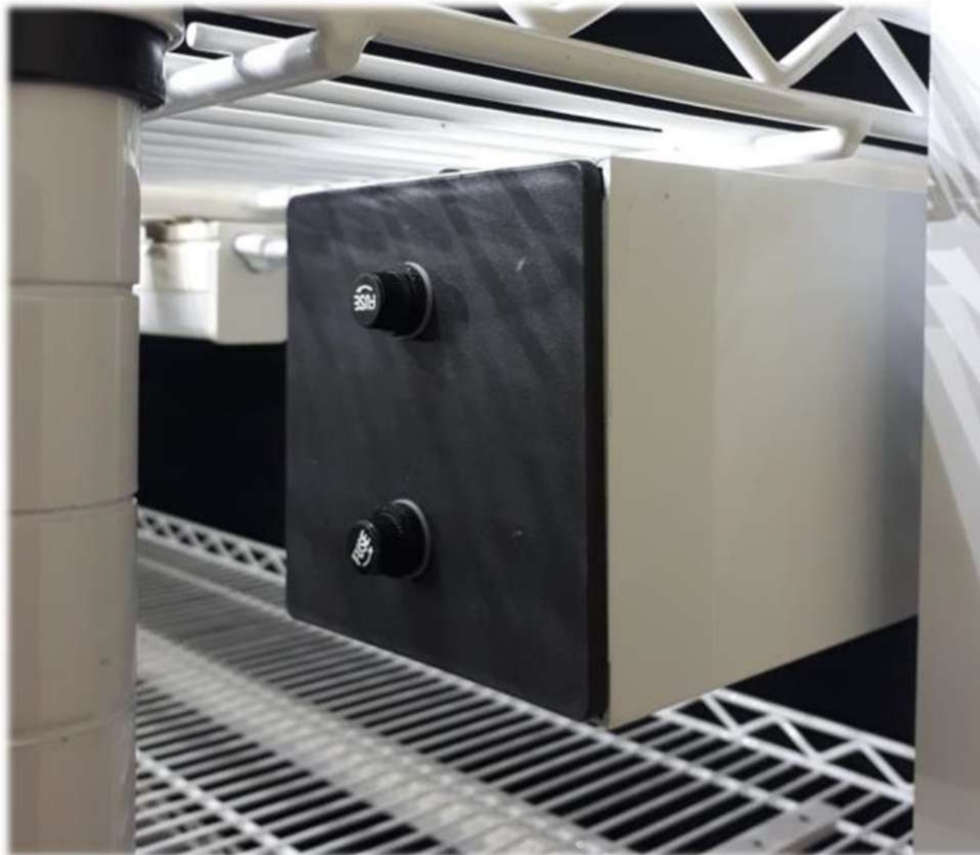
Proteções elétricas no timer e em todas as prateleiras evitando uma queima por sobrecarga de energia
